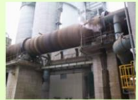
セメント工業の熱エネルギー回収：5%
